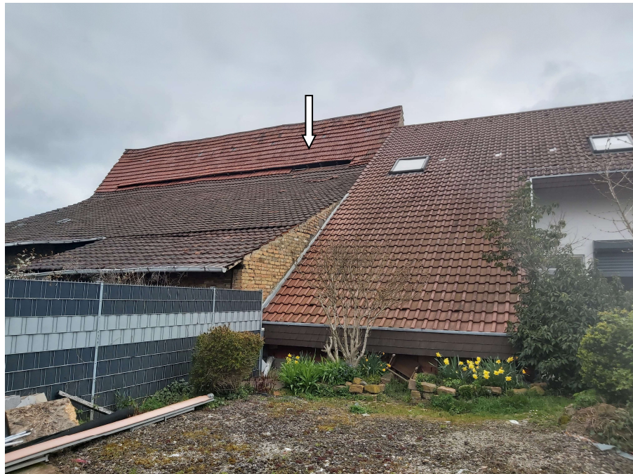
Foto 5: Dach Haus Mannheimer Straße 85 und Schuppen Haus Nr. 87 mit Dachöffnungen
